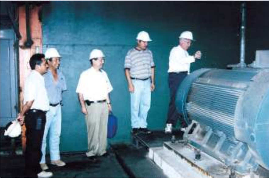
Un nuevo turbogenerador eléctrico, procedente de Brasil, fue instalado en el Ingenio La Unión en 2002. La foto registra el momento en que era bendecido por Monseñor Antonio Rodríguez (a la derecha). De izquierda a derecha observan los ingenieros Edwin Gamboa y Enrique Velásquez, el autor y el ingeniero Elfecho Arturo Bautista. El generador operó consecutivamente dos años, pero en el penúltimo día de la segunda zafra se descompuso por fallas de fabricación. La empresa fabricante WEB cumplió el compromiso de garantía, y lo repuso con una unidad nueva.
