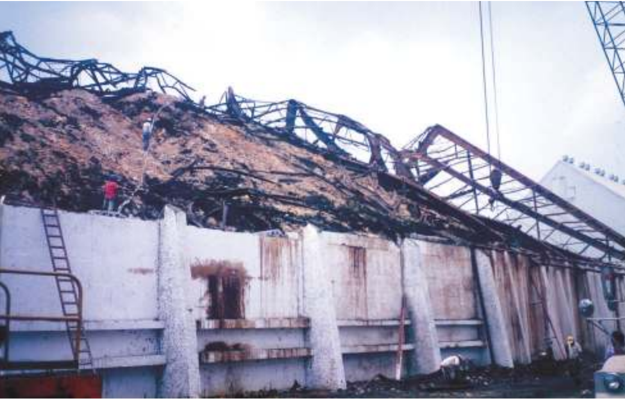
El 26 de marzo de 1998, un incendio accidental destruyó una bodega de azúcar cruda para exportación, en el Ingenio La Unión, sin causar víctimas. El azúcar, al quemarse, produce una llama baja, como cuando se quema alcohol. Las pérdidas derivadas del incendio fueron repuestas mediante la aplicación de los contratos de seguros vigentes. En América Latina no se reportaba un incendio semejante en treinta años.
